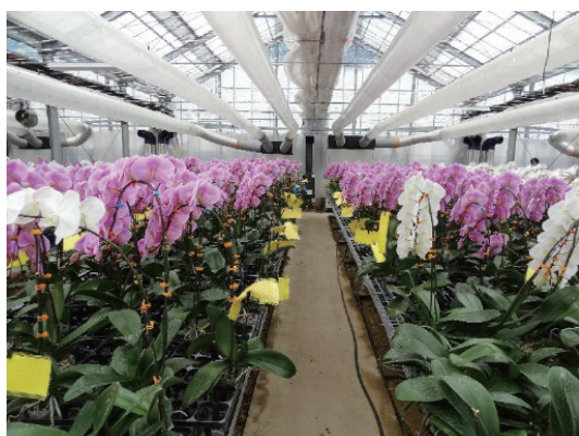
写真3 冷房効率を上げるためにヒートポンプに送風ファンとダクトを設置したファレノプシスのハウス (写真提供：石井雅久)
